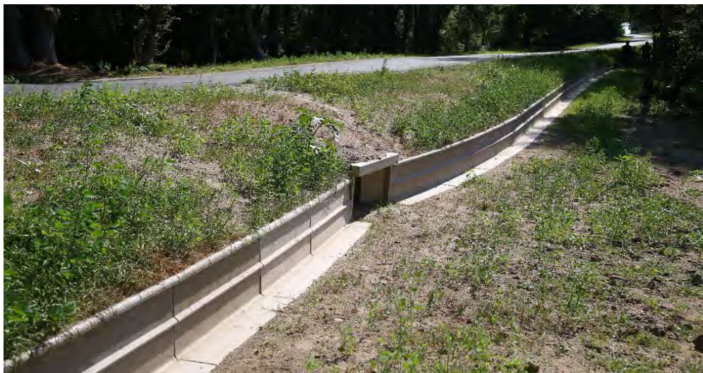
Fot. 12. Przejścia dolne dla drobnych kręgowców w Rybocicach / Photo 12. Underpass passages for small vertebrates in Rybocice
