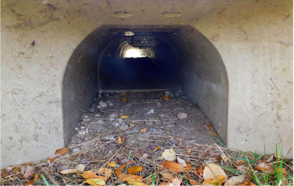
Fot. 23. Fotopułapka zainstalowana w tunelu systemu dolnych przejść dla drobnych zwierząt kręgowych / Photo 23. a camera trap installed in the tunnel of the underpass passage system for small vertebrates
